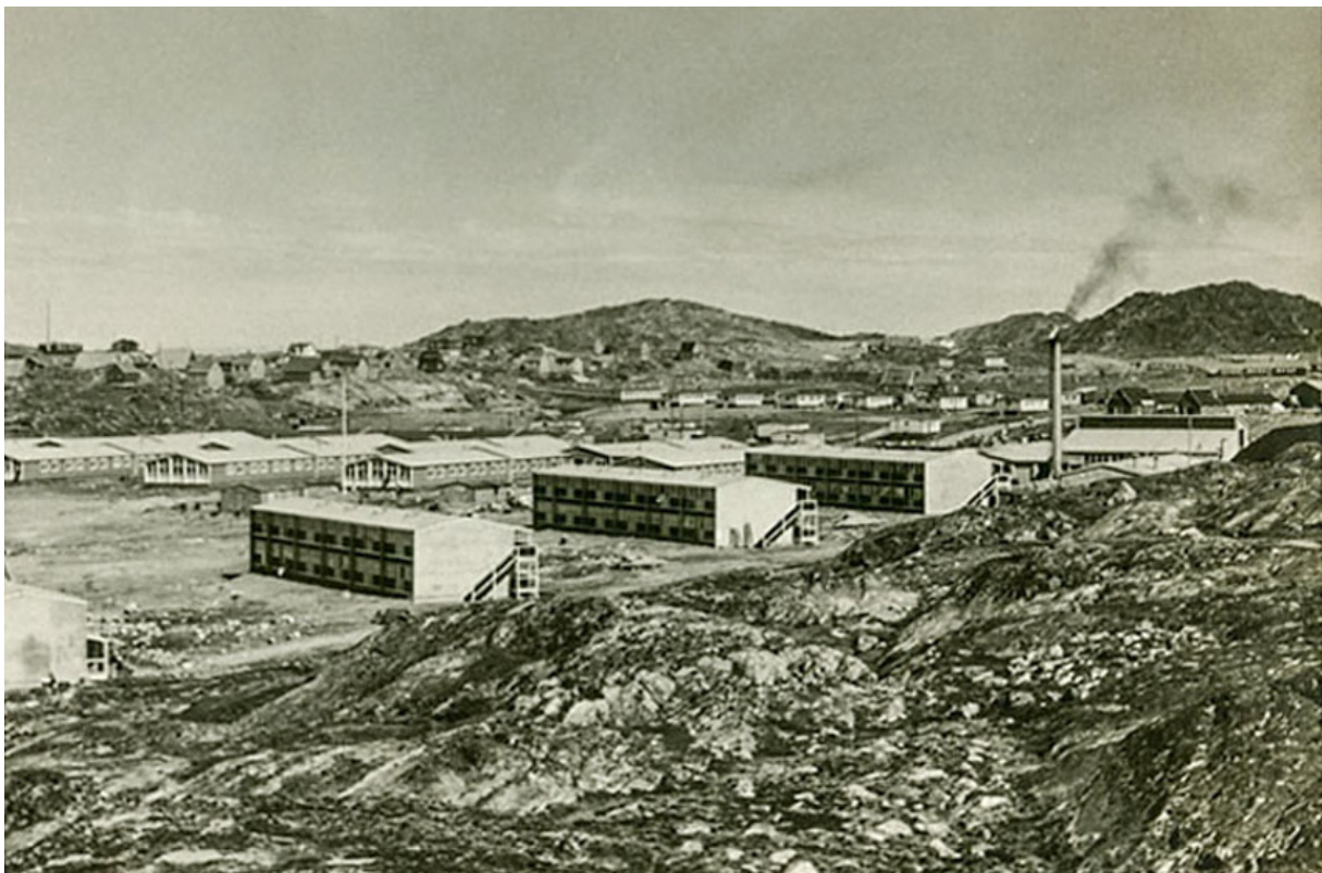
Dronning Ingrid's Sanatorium under opførelse i 1954. (Fra sygeplejerske Anna Mardal Jensens billedsamling).
